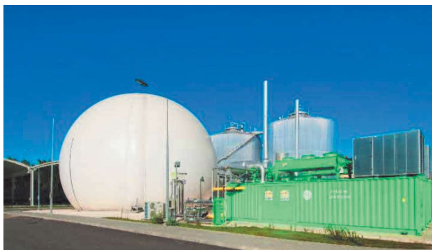
Figura 22 - Motor de biogás e gasómetro
